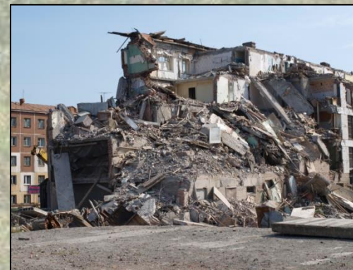
Снесенны й аварийный жилой дом
